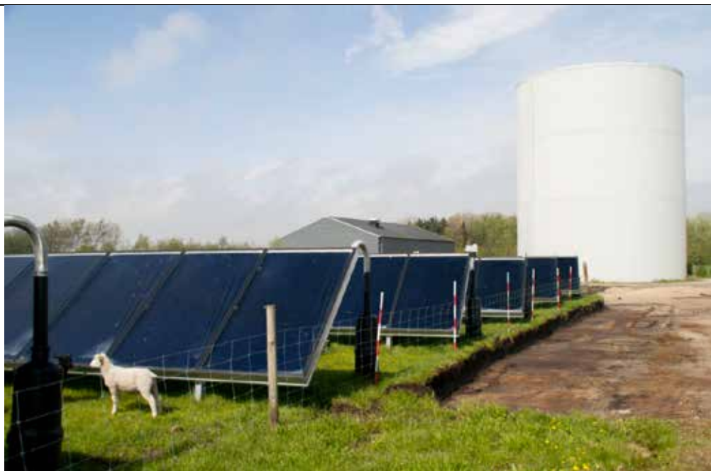
FIGUR 15: SOLFANGERFELT TIL FJERNVARME OG AKKUMULERINGSTANK (ASAA FJERNVARME)
