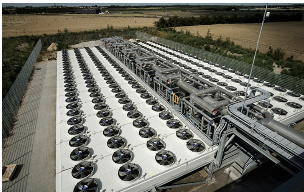
FIGUR 13: KØLEGÅRD TIL LUFTVARMEPUMPEANLÆG.
